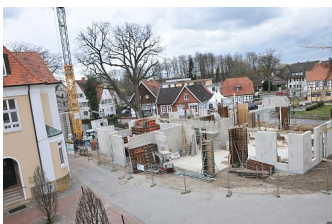
Aus den Bürofenstern von Runa Reisen lassen sich die Bauarbeiten am Eckgebäude des Schlichte-Carrees verfolgen. Hier soll neben weiteren Büros die Gemeindebibliothek einziehen. Zurzeit wird das Erdgeschoss gemauert. (© Frank Jasper)
