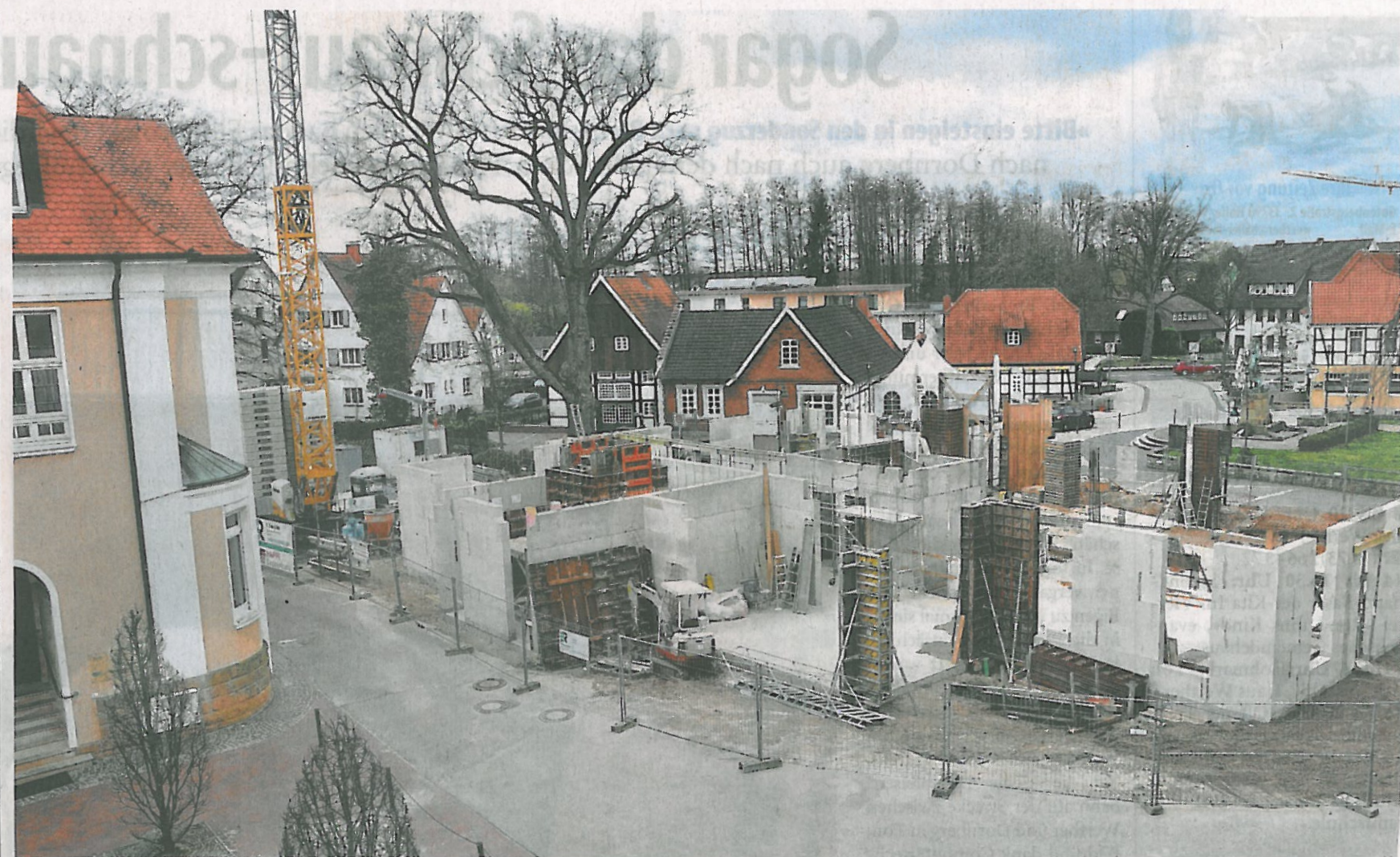
Gegenüber: Aus den Bürofenstern von Runa Reisen lassen sich die Bauarbeiten am Eckgebäude des Schlichte-Carrees verfolgen. Hier soll neben weiteren Büros die Gemeindebibliothek einziehen. Zurzeit wird das Erdgeschoss gemauert.
